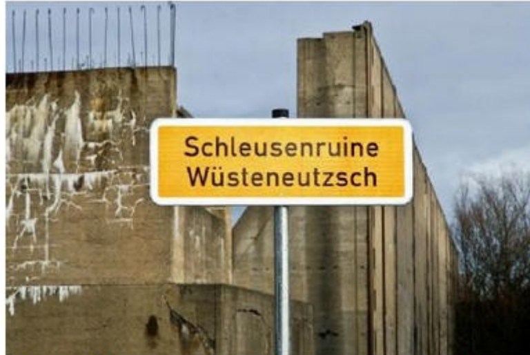
Die Schleusenruine Wüsteneutzsch steht auch heute noch. Ihr Zustand ist jedoch ruinös. (BILD: MARCO JUNGHANS)
